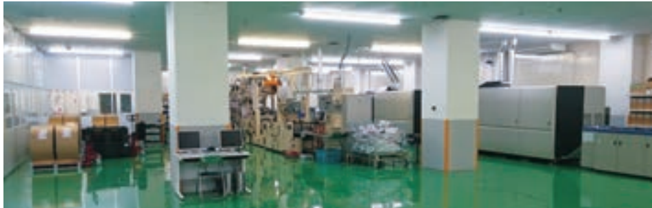
最新鋭高精細インクジェット印刷機が設置されたさいたまサテライト
